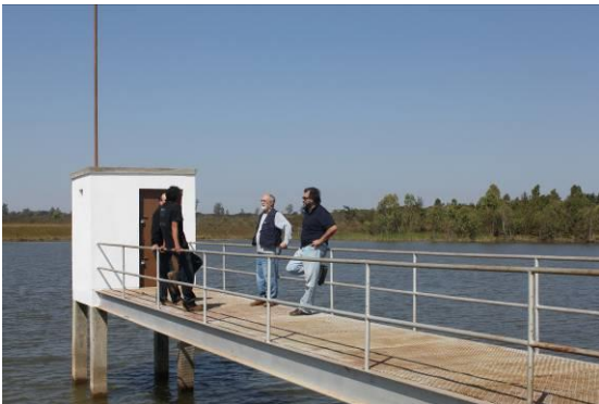
Caseta de la bomba de 250 KVA
